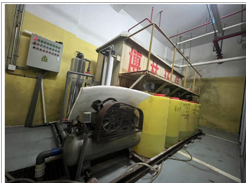
自建污水处理站
