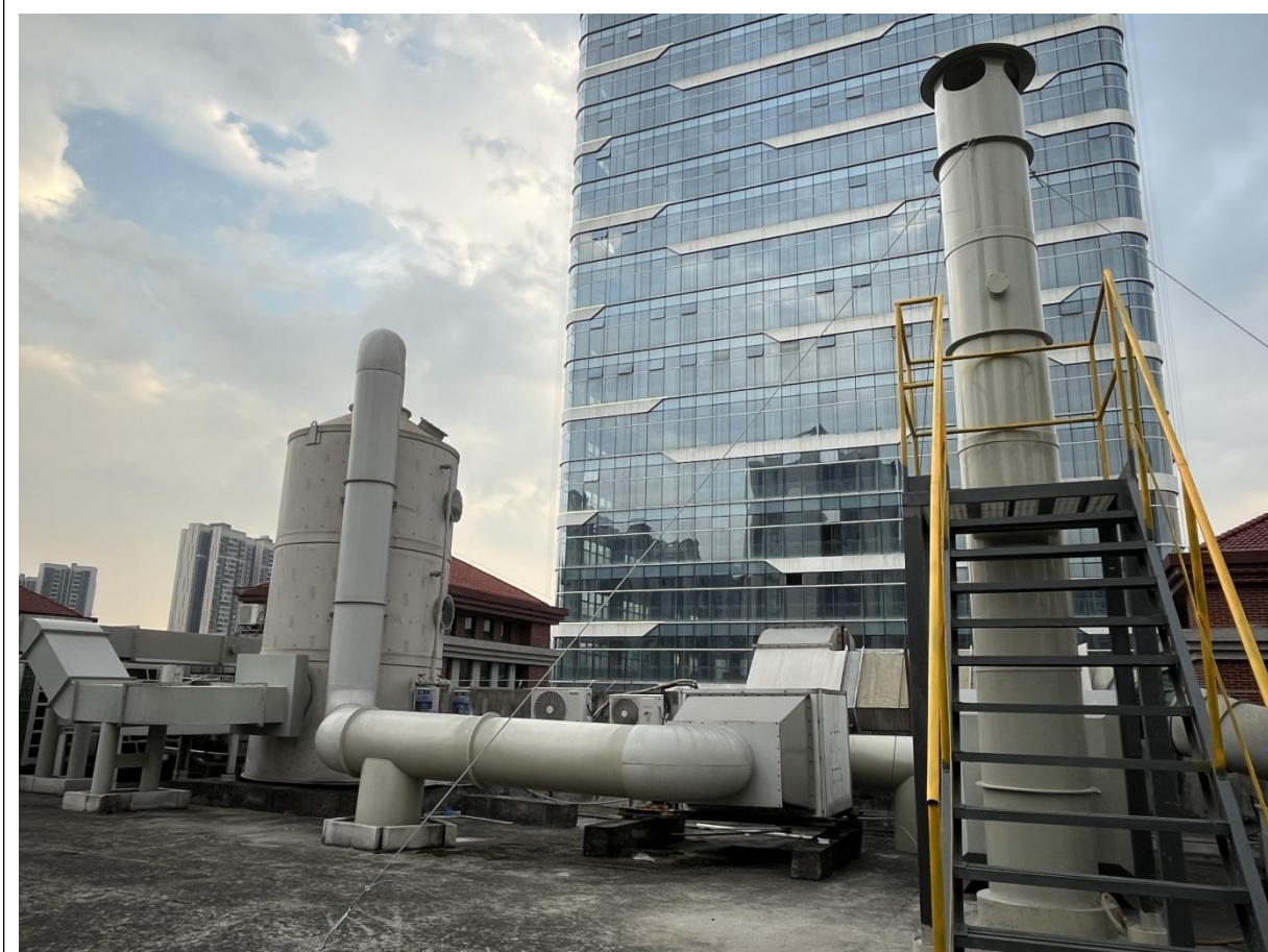
碱液喷淋+活性炭吸附装置
