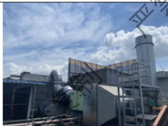
UV 光解净化器+活性炭吸附装置 (原有项目：气-01)
